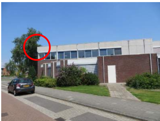
Foto 9 & 10 gevel met opening achter de gevelplaat
