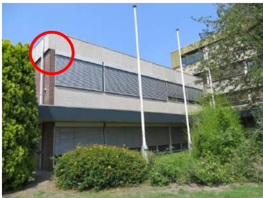
Foto 7 & 8 gevel met opening achter de gevelplaat
