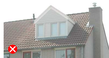
vormgeving sluit niet aan op stijl van woning
