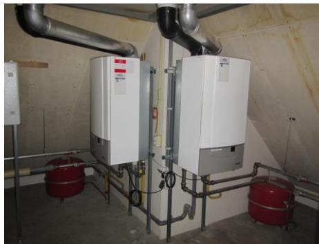
niet verdachte HR cv ketels / Foto R
