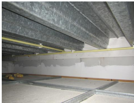
niet verdachte brandwerende beplating boven plafonds en in wanden / Foto P
