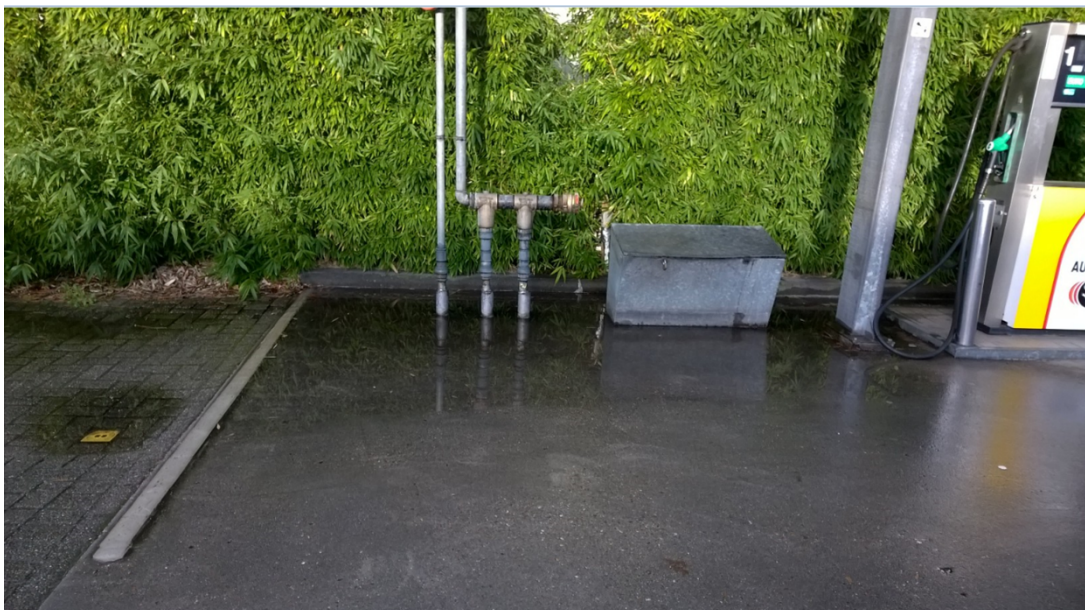
Foto 1: Vulpunt op de vloeistofdichte vloer. Plasvorming in de hoek van de vloer.
