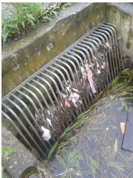
Riooloverstort van gemengd rioolstelsel
