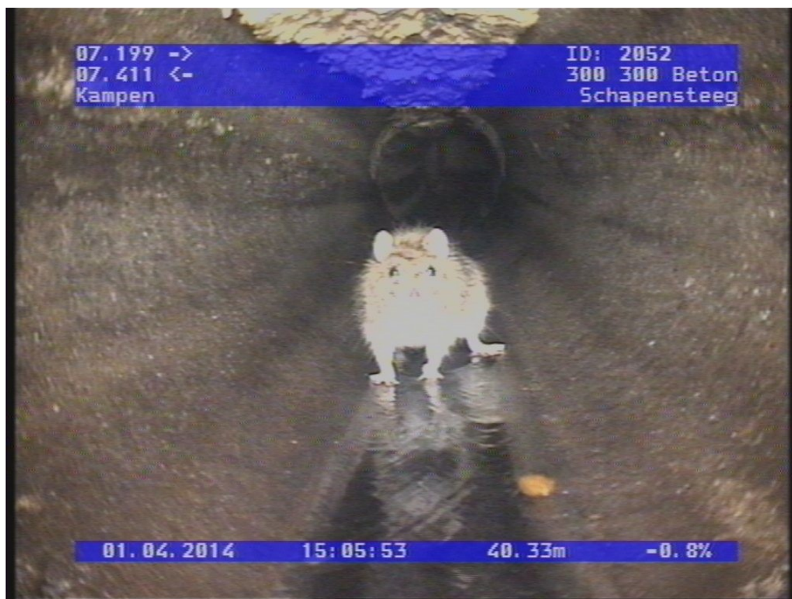
Rat in het riool Schapensteeg, inspectiejaar 2014
