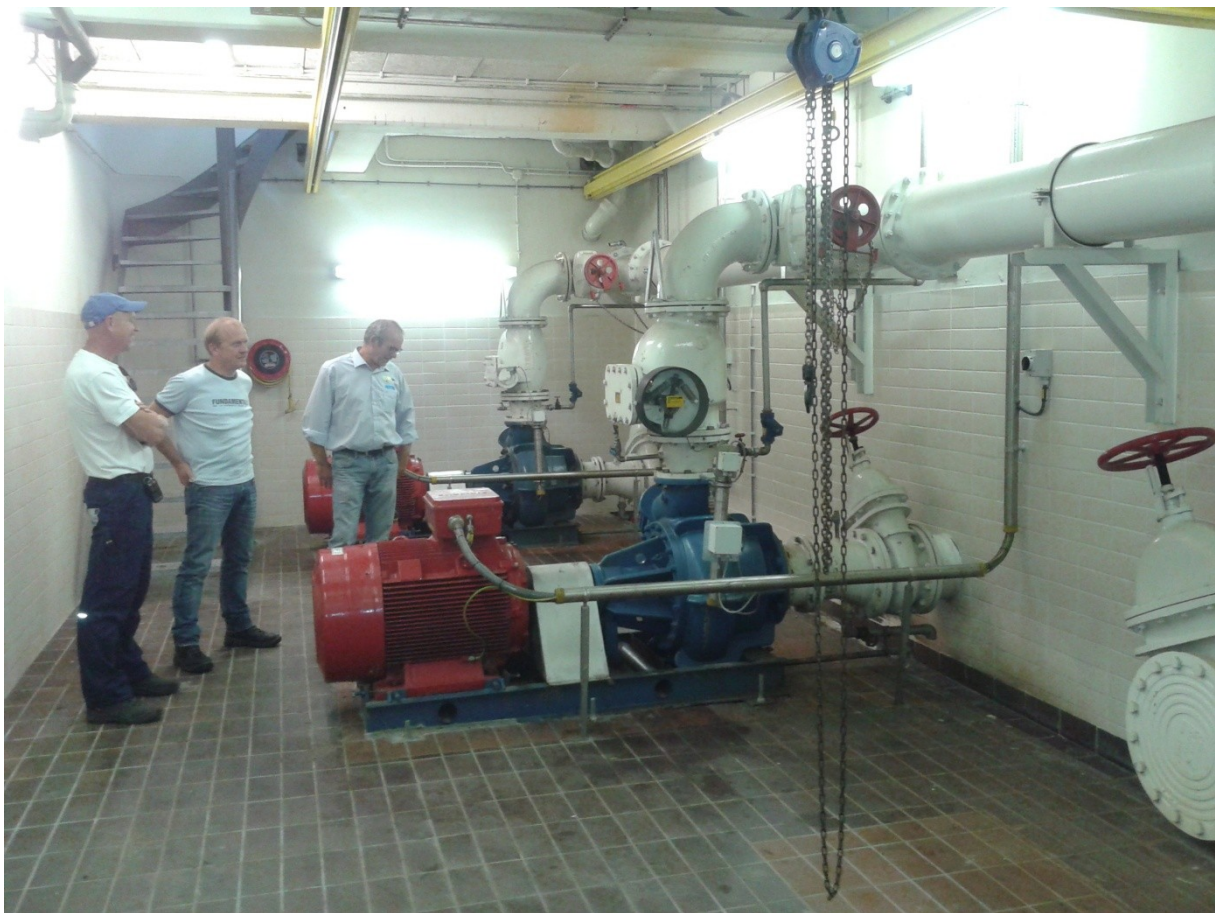
Hoofdrioolgemaal Bergweg te IJsselmuiden
