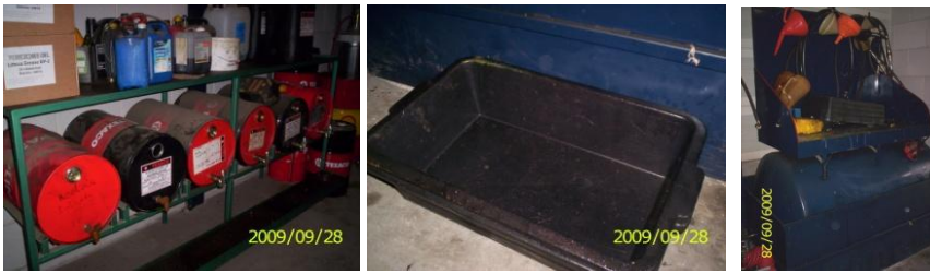
(Fig 7 v.l.n.r. vulplaats olie, opvangbak en oliedepot)
