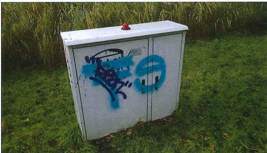
Figuur 4 Buitenopstelling(schakel-)kast stuw 19197 st
