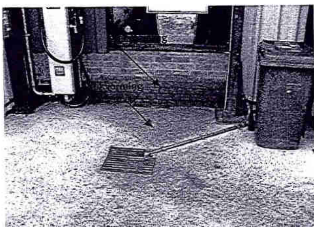
Fotonummer: 3 Omschrijving: Aanzicht vloer tankplaats, afvoerpunt hemelwater en vlekvorming.
