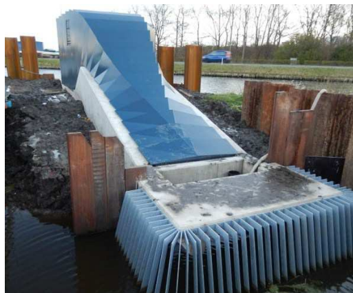
In 2015 opgeleverd poldergemaal Elstgeesterpolder-West
