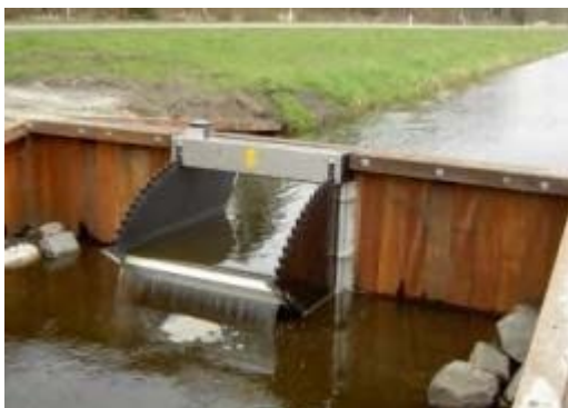
Figuur 10 Voorbeeld stuw (klepstuw) (bron: KWT)
