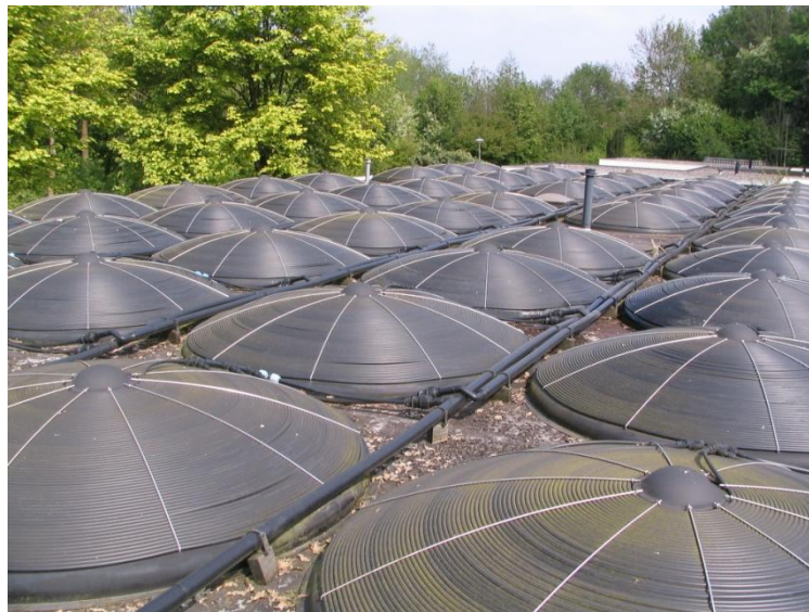
Zonnecollectoren voor de verwarming van het zwembadwater
