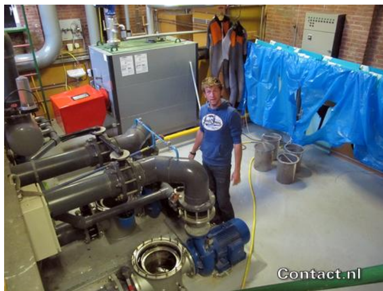
Jaarlijkse onderhoud aan de machinekamer
