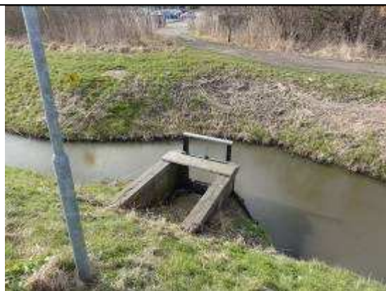
Stuw 306-056-00029 tussen golfbaan Houtrak en Machinetocht
