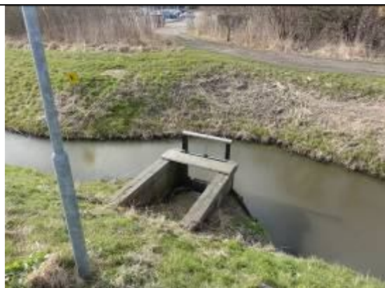
Stuw 306-056-00029 tussen golfbaan Houtrak en Machinetocht
