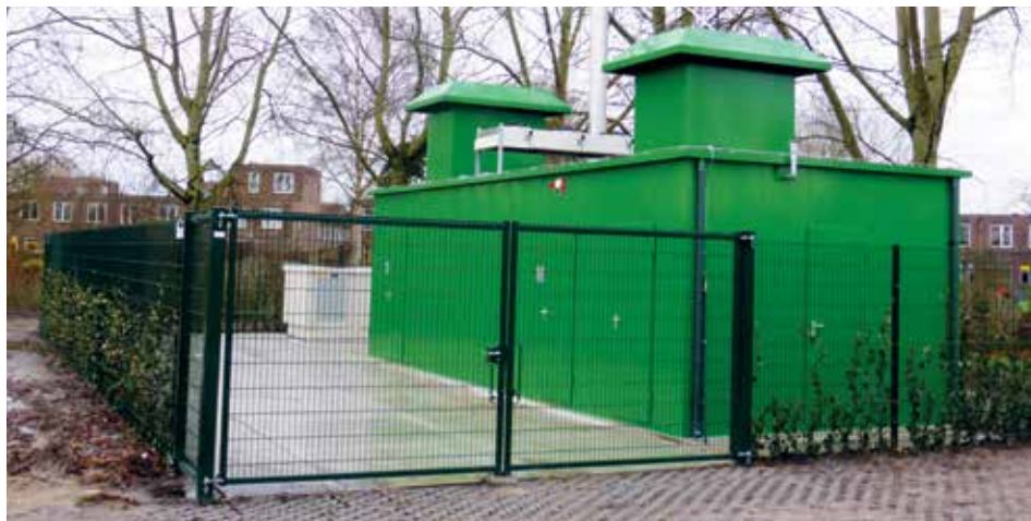
Groen warmtestation: met de restwarmte van de RWZI Nieuwveer worden circa 450 woningen in Breda verwarmd (Bron: Henri Maas)
