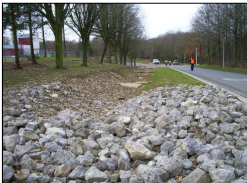
Regenwaterstructuur Jan Campertstraat
