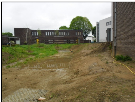
Infiltratiebuffer klooster Grasbroek
