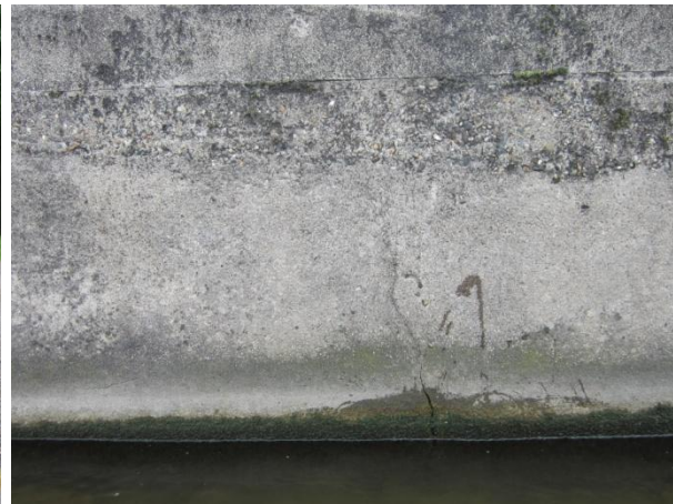
Figuur 6.8: Locatie C: Scheur in beton.
