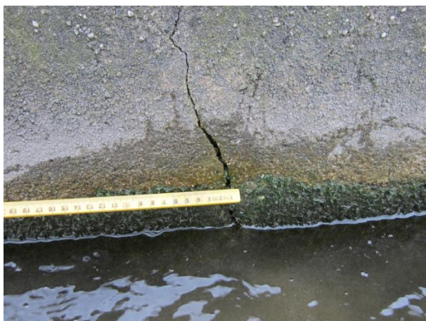
Figuur 6.9: Locatie C: Scheur in beton.
