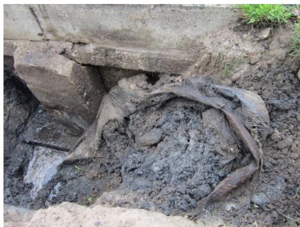
Figuur 6.4: Locatie B: Resten geotextiel.
