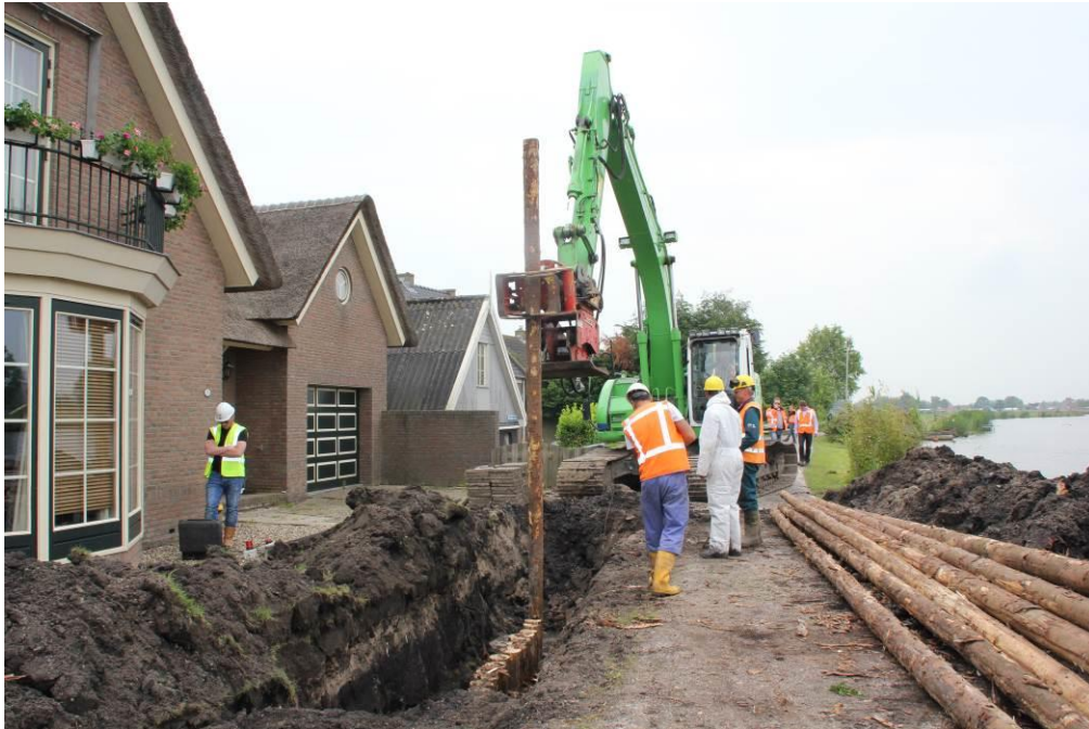
Figuur 4.3 Voorbeeld van het aanbrengen van een afschermconstructie van houten palen bij een pand in Nessersluis
