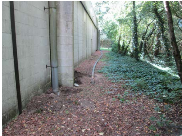
Foto 6: Aanvoerleiding naar lozingspunt op schoonwaterriolering
