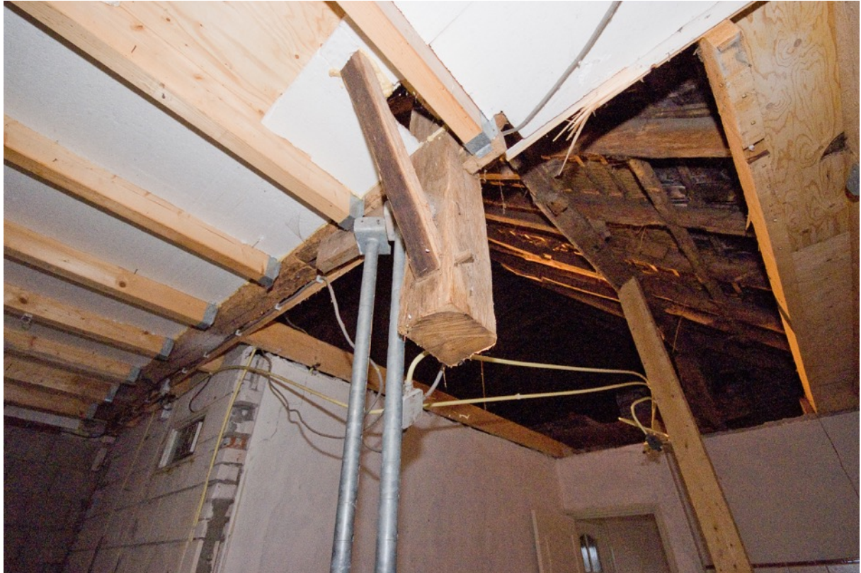
Foto 16: Afgezaagde gebintstijl, september 2007. Zes andere gebintstijlen waren op vergelijkbare wijze verdwenen.
