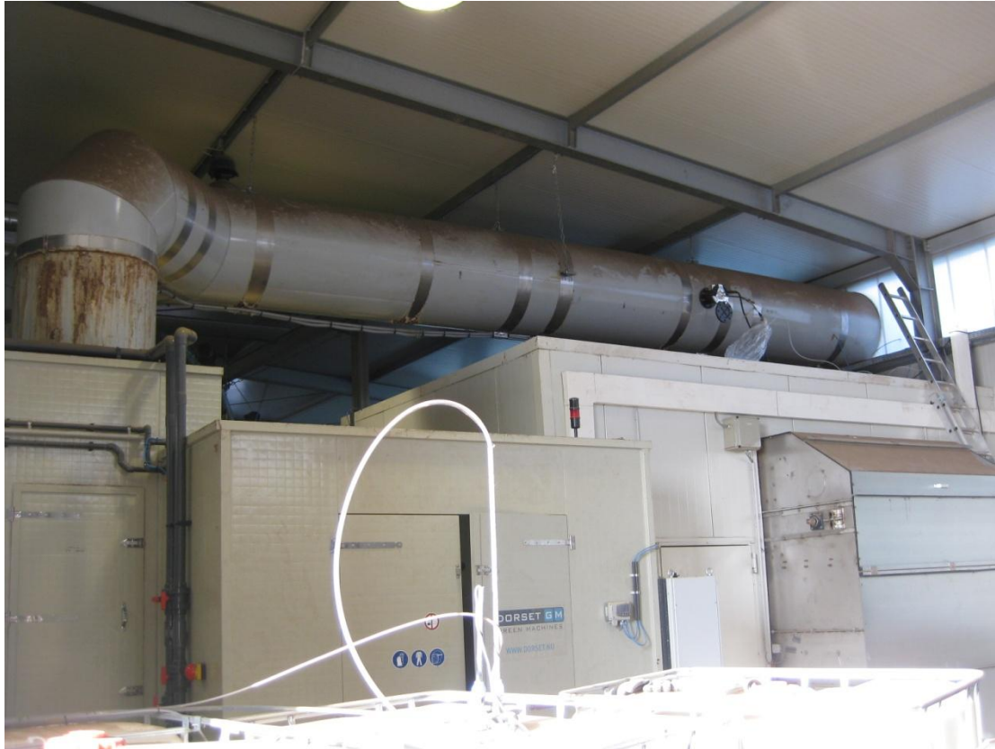
Figuur 3.6 Afbeelding luchtleiding na gaswasser
