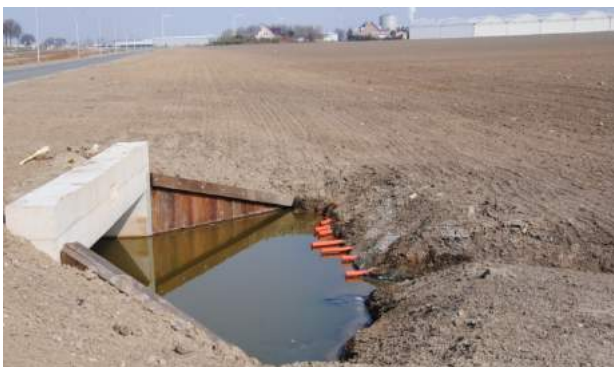
6. Drainage t.p.v. duiker onder haakse bocht Cyclamenweg en aantakking greppel (zie foto 12)
