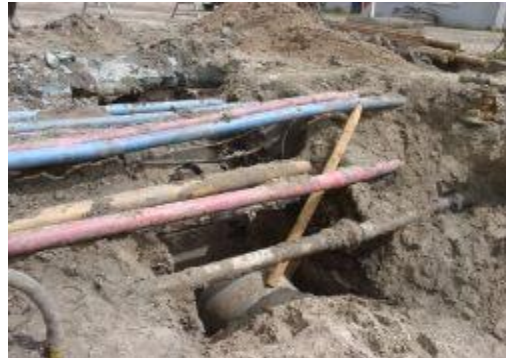
Kabels en leidingen
