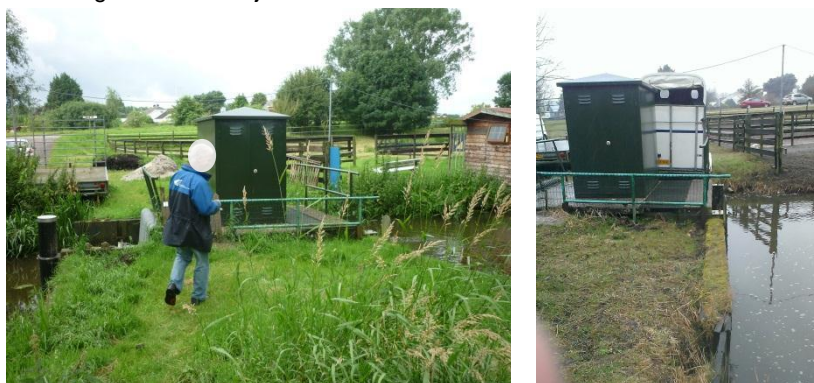
Afbeelding 18 en Afbeelding 19: Gemaal Grindweg
