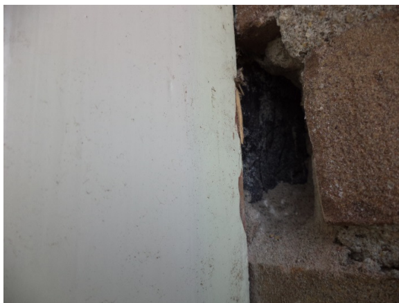
Foto 1. Spouwstrook, Pastoor Willemsestraat 48
