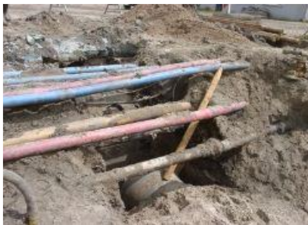
Kabels en leidingen
