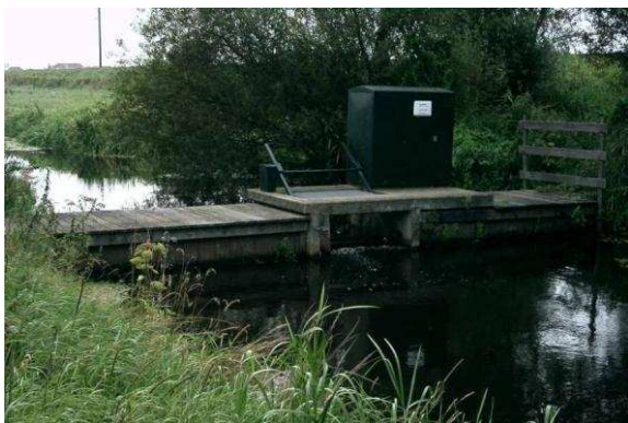
Foto 3.4: automatisch stuw die zorg draagt voor afvoer vanuit de Nessepolder
