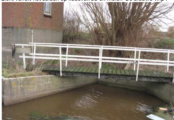
Instroomconstructie sifon kadevak 5B met daarnaast gemaal.
