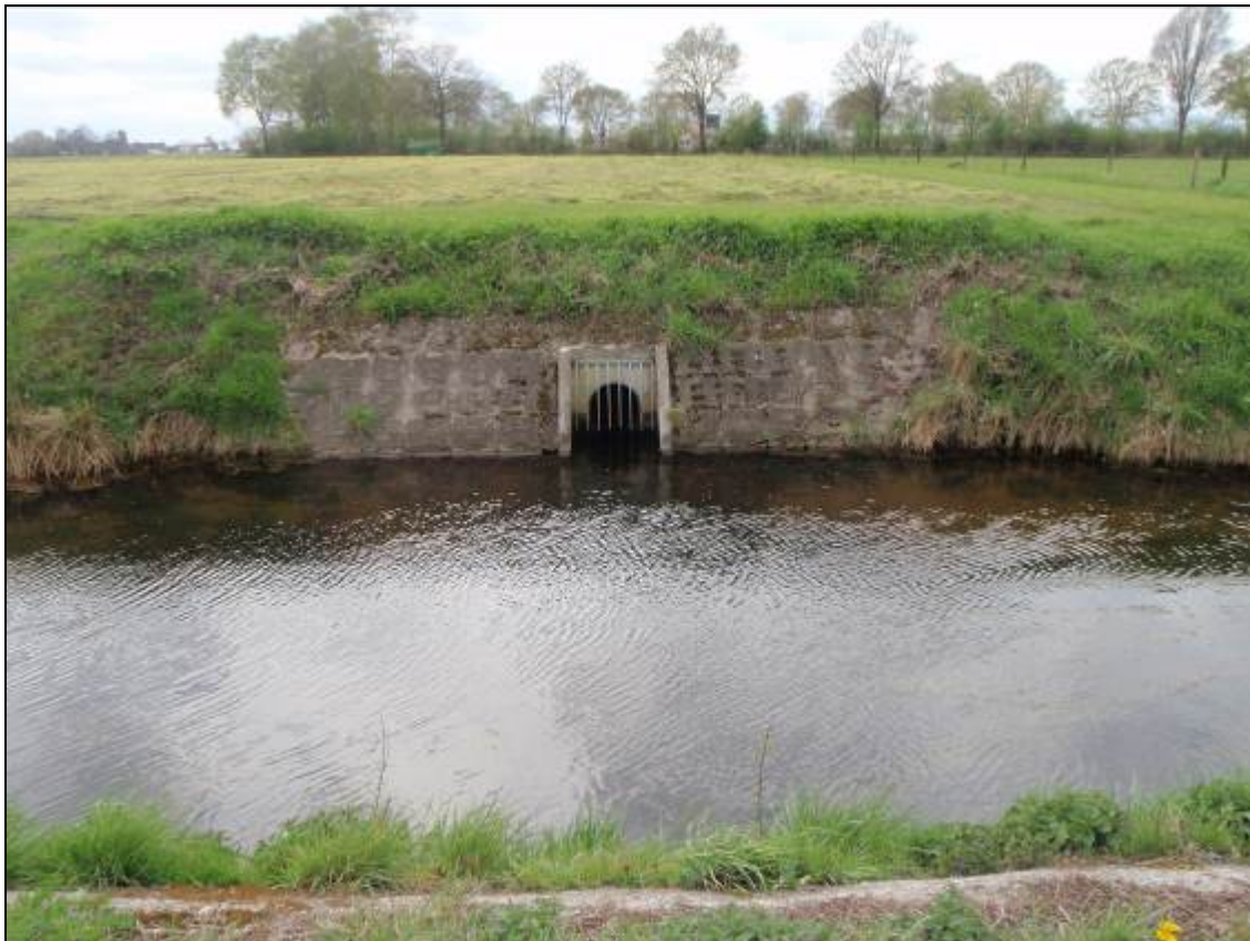
Foto 4: lozingspunt van de effluentleiding RWZI Riel
