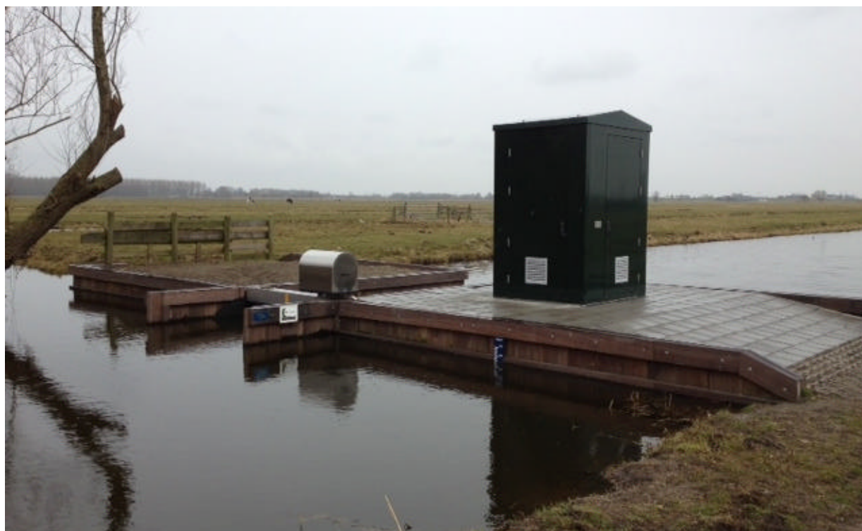
Foto 12. Stuw de Mient, peilscheiding tussen GPG-133 en GPG-135.
