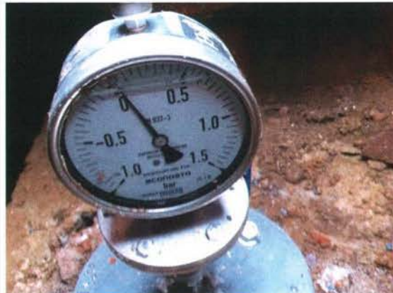
Afbeelding 3.6: DWA-pomp in bedrijf
