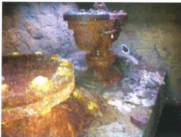
Put zijde Voorstraat: T-stuk en be- en ontlufter
