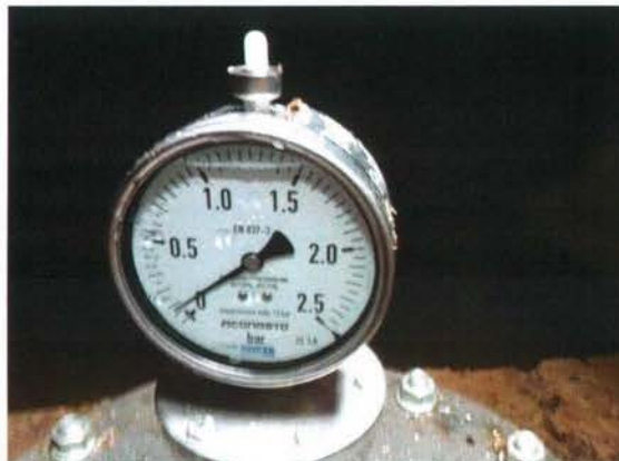
Afbeelding 3.2: DWA-pomp in bedrijf
