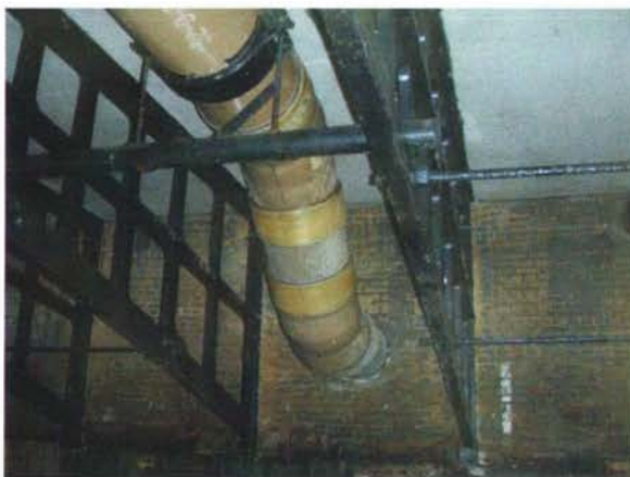
Afbeelding 2.3: oplegging rioolpersleiding op spanten
