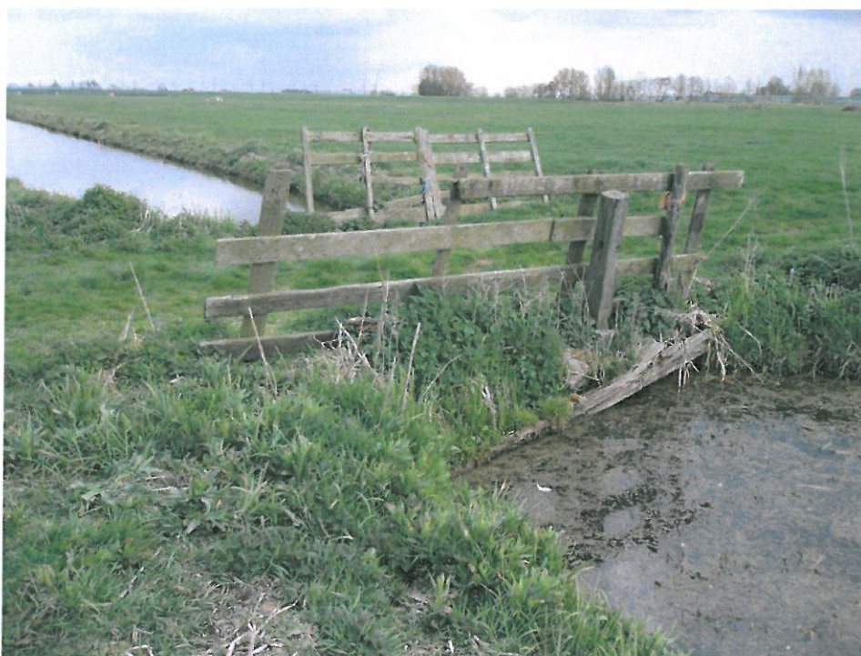
Foto 4. Aanzicht van grond dam 1, in zuidelijke richting. Maatregel: Leveren stalen duiker, lang 6m, diam. 800mm. Aanleg door pachter/eigenaar aanliggende gronden.
