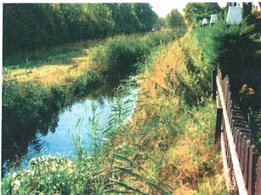
Dichtgroei van taluds / watergang tgv rietgroei aan taludkanten
