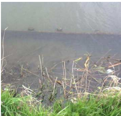
Figuur 8a: Beschoeiing onder water en erosie
