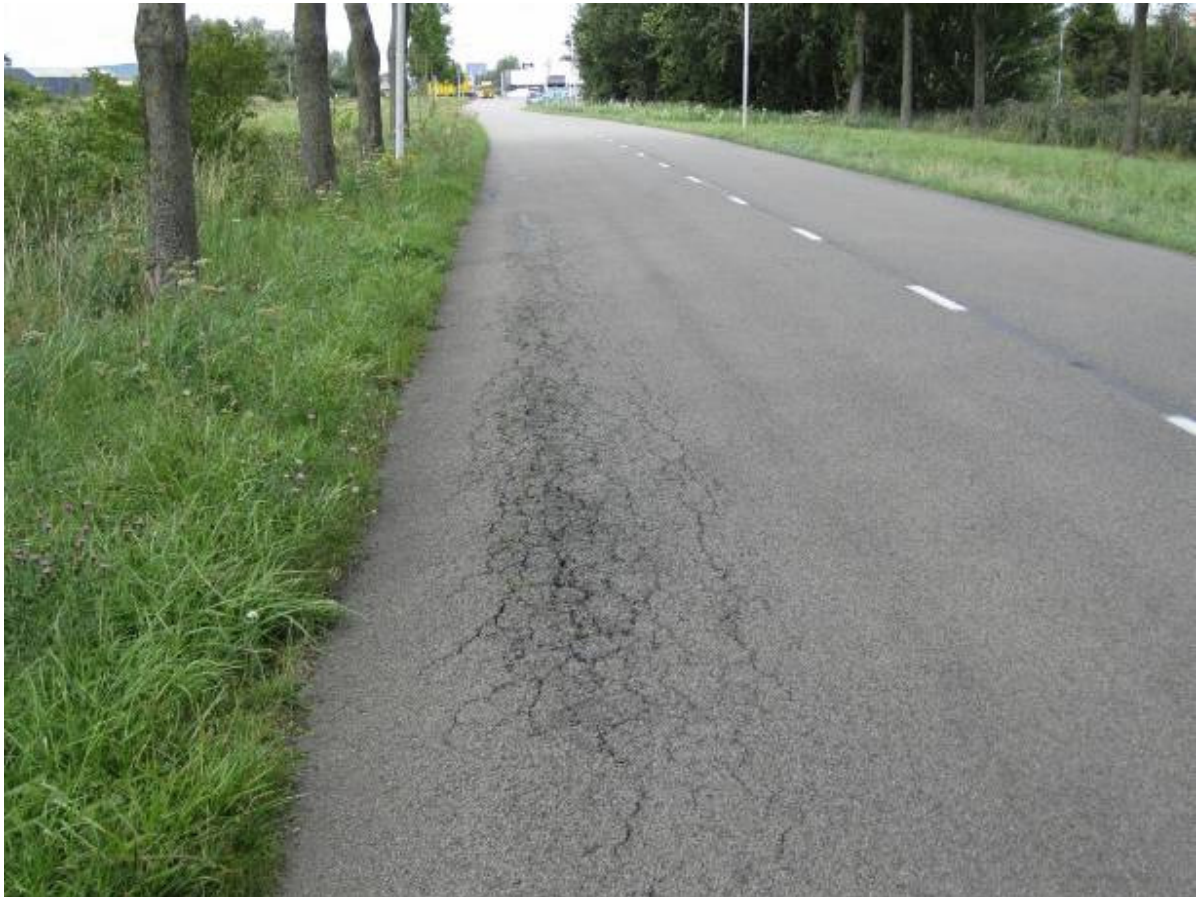
voorbeeld van scheurvorming
