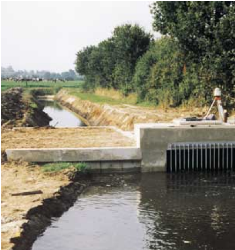
Wateraanvoer via gemaal Vogelenzang.
