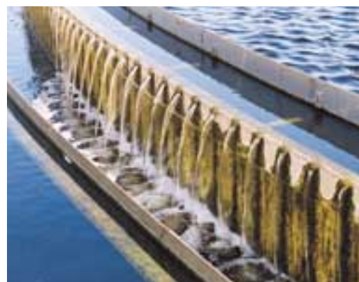
Gezuiverd afvalwater stroomt over de rand van de nabezinktank, waarna het kan worden geloosd of hergebruikt.
