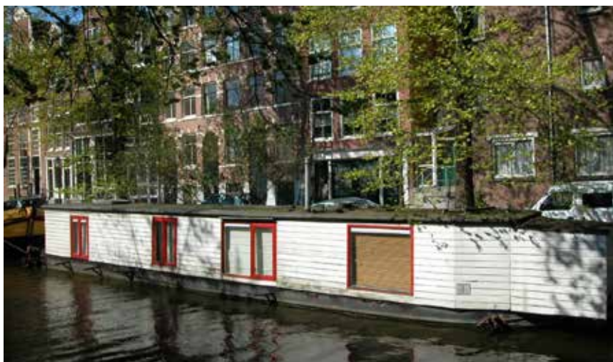
Ramen sluiten direct aan op casco of dak, hetgeen niet is toegestaan
