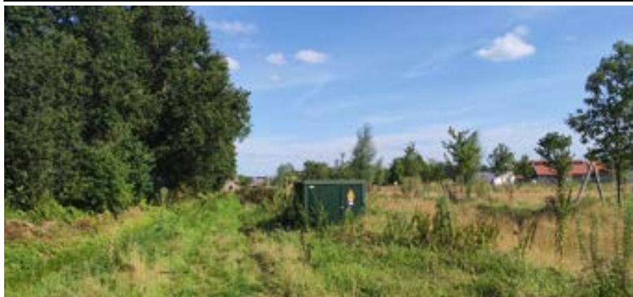
Afbeelding 36: Trafo in de Groene mal
