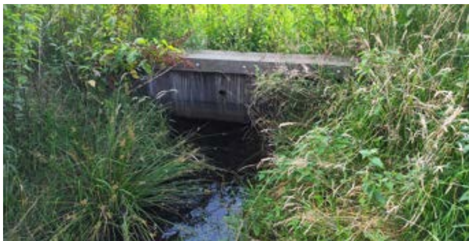
Afbeelding 24: Houten dam dienend als overstortconstructie naar waterschapssloot
