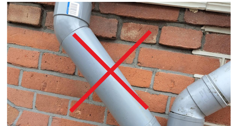
Geen zichtbare pvc-buizen in het zicht aan kopgevels
