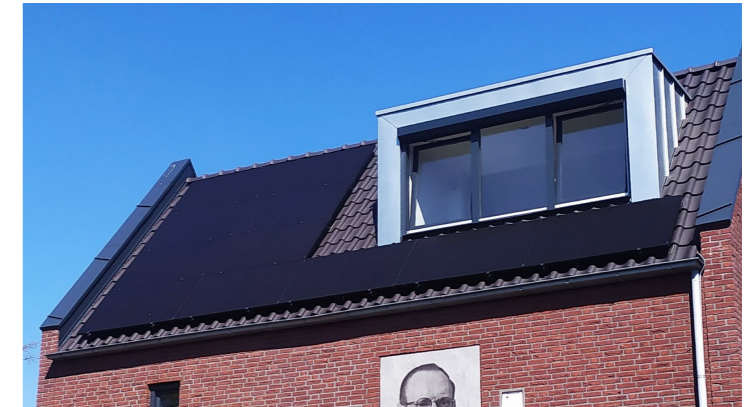
Zonnepanelen in kleur van dakbekleding
