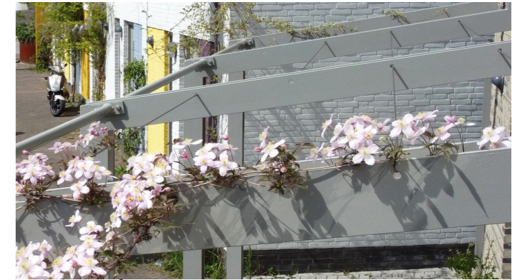
Zichtbare afwatering via pergola
