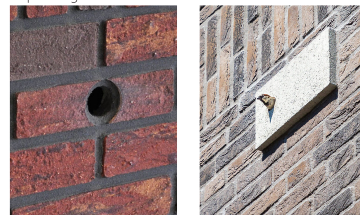
Nestkast verwerkt in architectuur
