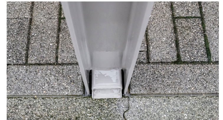
Zichtbare afwatering via pergola
