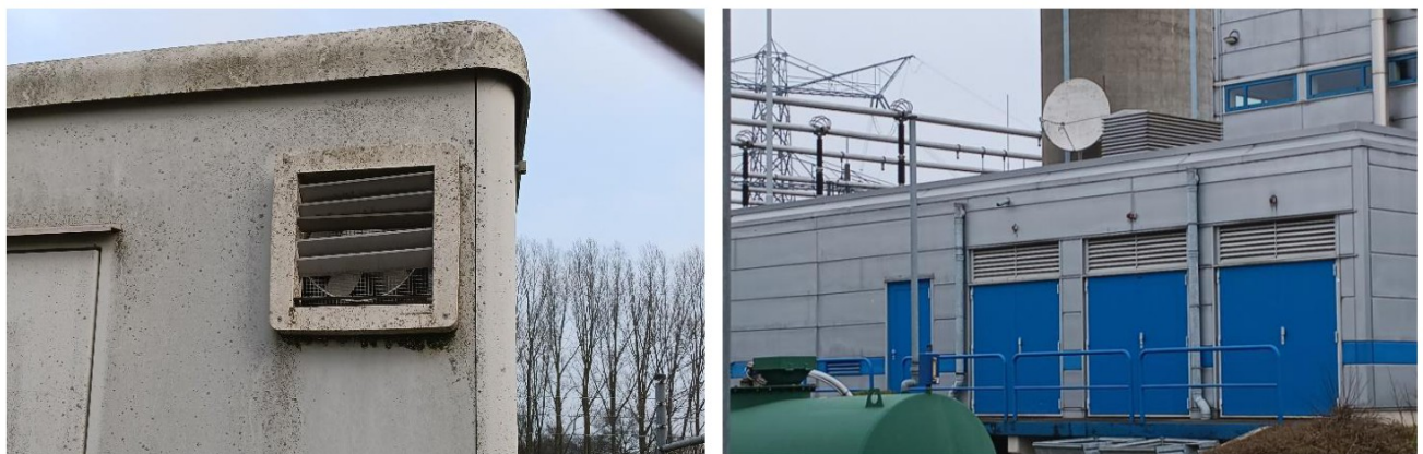
Figuur 4.3: Aangetroffen ontoegankelijke openingen voor vleermuizen.
