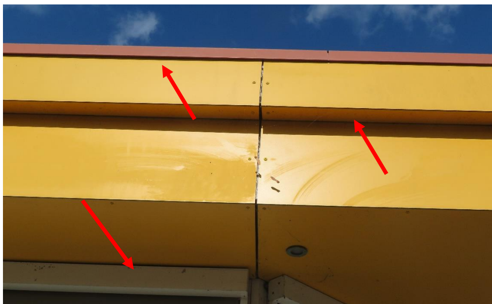
Goed sluitende gevelbetimmering (trespa plaat) en geen geschikte wegkruipmogelijkheden voor vleermuizen.
