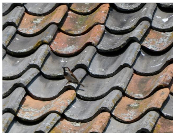
Figuur 5.2 Huismus op het dak van het woonhuis met openingen tussen de dakpannen.
