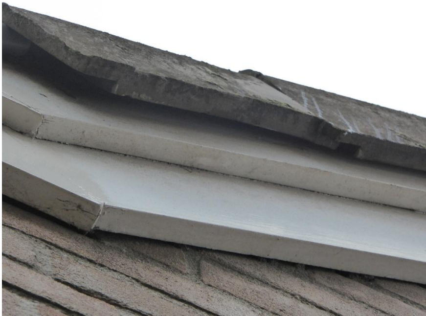
Geschikte boeilijst dak voor vleermuizen
