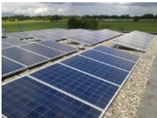
PV-panelen op plat dak
