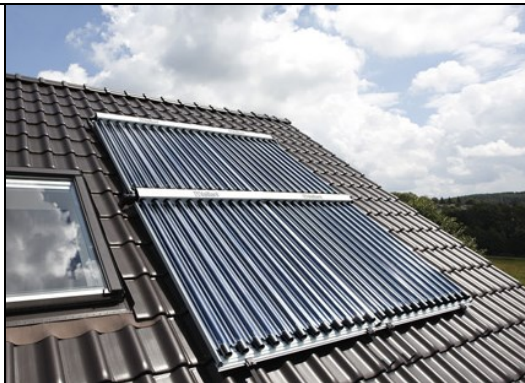
Zonnecollectoren met heatpipes
