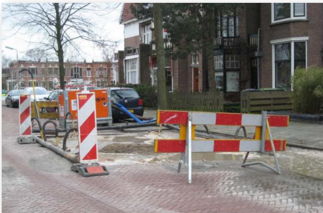
Afbeelding 25: ernstige schade in de vorm van een gat in de weg door riolinstorting
