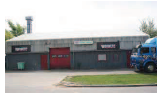
slecht onderhoud, laagwaardig materiaalgebruik en een onsamenvangende gevelopbouw.
