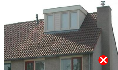
niet passend door plaatsing
