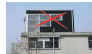
Dakopbouw waarvan de kozijnindeling niet aansluit bij de bestaande kozijnindeling.
