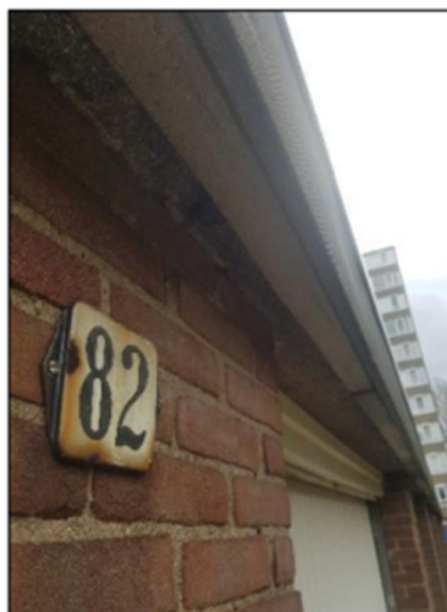
Afbeelding 7: Garageboxen zonder (toegang tot een) spouw, zonder ruimte bij de dakrand of enige andere toegang tot een geschikte ruimte. De garageboxen zijn voorzien van een plat bitumen dak en zijn laag.
