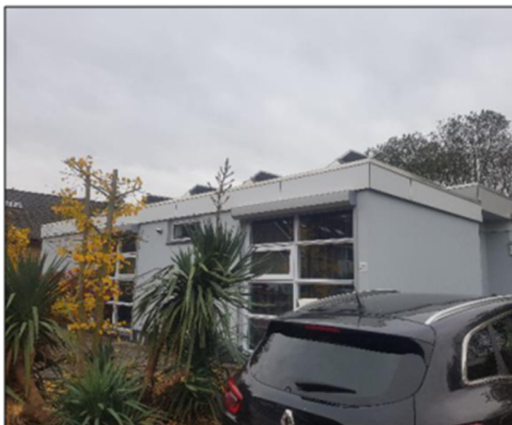
Afbeelding 8: Een van de woningen die als 'totaal ongeschikt' is aangemerkt, ter plaatse van 'A' in Afbeelding 6. De muren beschikken niet over stootvoegen, er is geen ruimte aanwezig onder de trespas dakomlijsting, er is geen ruimte onder de dakstrip, het dak zelf is plat en bekleed met bitumen en biedt geen toegang tot geschikte ruimtes. De bebouwing is enkellaags en voorzien van verlichting.
