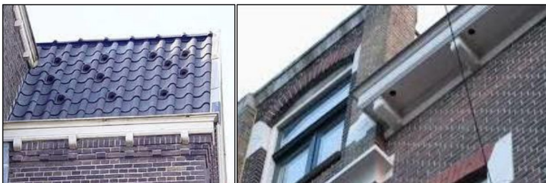
Figuur 11: Links: speciale pannen; rechts ruimte in de gootbetimmering
