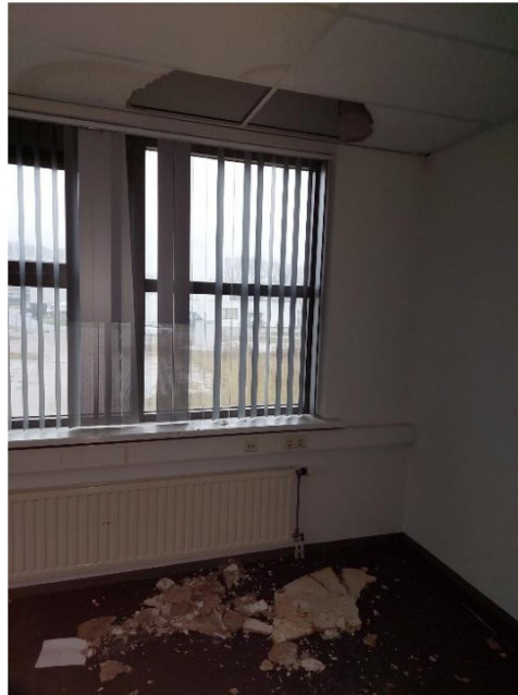
2. Een van de daklekkages
